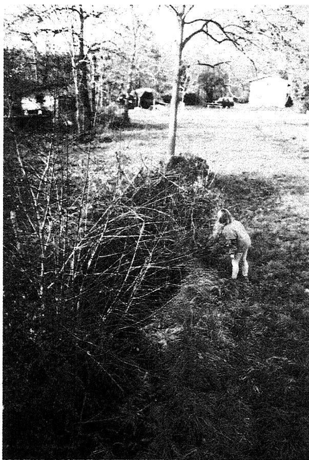
Fig. 7 - Fratture aperte (rivestite dalla vegetazione) presenti nel Conglomerato di Pontegana lungo il bordo sommitale della parete di Sottosassi (Morbio Inferiore). L'orientazione delle strutture è compresa fra NW-SE e N-S (Foto M. Felber).
