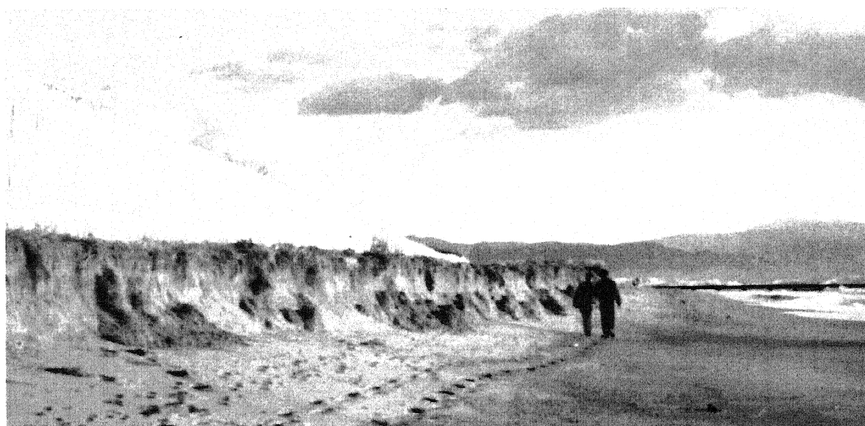
Fig. 9 - Tratto tra Lido Corsaro e Pontile in corrispondenza del c.s. n. 49. Scarpa subverticale incisa nel cordone dunare a fronte mare dalla mareggiata del novembre '96. La scarpa è alta oltre 2 m, l'arretramento del ciglio è pari a 12 m.
