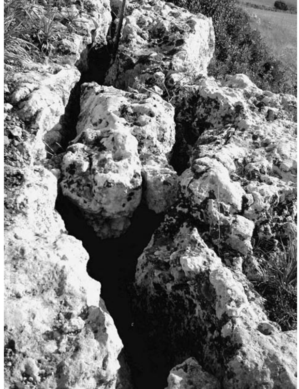
Fig. 8 - Il Calcarea di Tarquinia è profondamente e intensamente fratturato e la rapida e massiccia infiltrazione delle acque ne provoca la continua corrosione.
