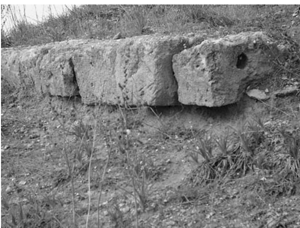
Fig. 11 - La perdita di sostegno, indotta dall'erosione delle Sabbie gialle sulle quali era fondata la cinta muraria di Tarquinia vecchia, ne mette a rischio la stabilità in più punti.
