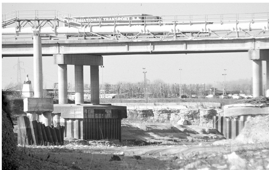
Fig. 1 - Erosione dell'alveo del Fiume Secchia, poco a valle di Sassuolo (Modena). Channel degradation in the Secchia River, downvalley Sassuolo (Modena).
