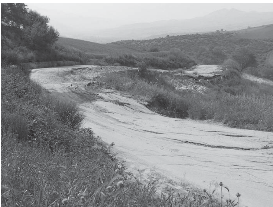
Fig. 4 - In alto: muro di sostegno travolto da una frana; si osservano frane superficiali in terreni essenzialmente argillosi del "Flysch Rosso" (Valle Capo Diavolo, Rocchetta Sant'Antonio). In basso: sede stradale (SP99bis Rocchetta-Rocchetta Scalo) danneggiata da un movimento franoso.
